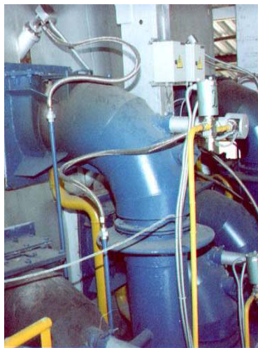
Arzatoare modernizate - CAF 50 Gcal/h
